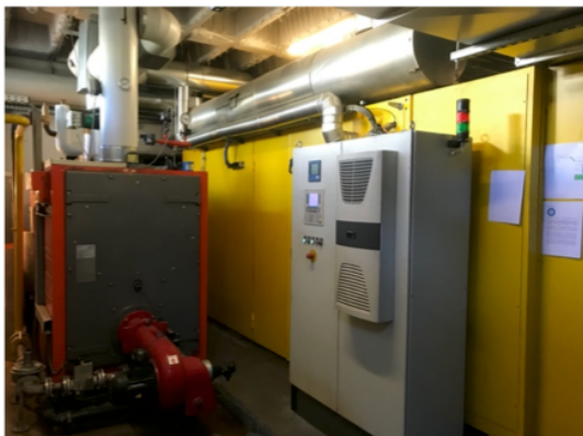
Abbildung 3: links der Erdgaskessel, rechts das BHKW
